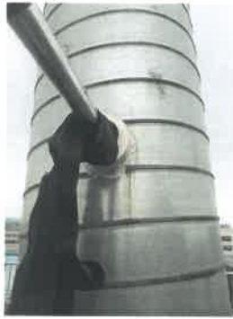
食堂油烟废气处理后排放口
