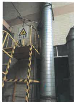
机加工打磨工序废气处理后排放口
