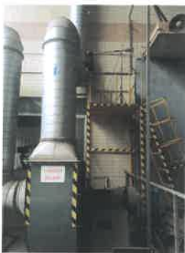
焊接工序废气处理后排放口
