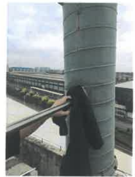
固化工序废气处理后排放口
